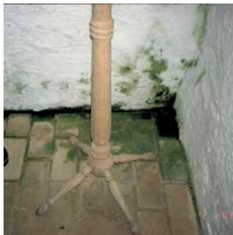
Billede 1. Alger på væg og klinkegulv ved opstigende fugt og lysindfald.
