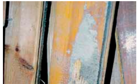
Billede 5. Skimmelsvamp ses under et gulv efter vandskade.
