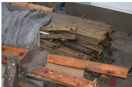
Billede 2. Byggematerialer, der ligger frit ude i regnen, kan ikke anvendes og bør kasseres.
