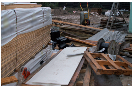
Billede 1. Rod, fugt og skimmel på byggepladsen giver dårligt byggeri.
