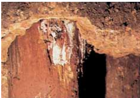
Pælefundering angrebet af Mastesvamp efter at grundvandet er blevet sænket og luftens ilt er trængt ind.
