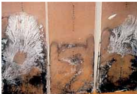
Mycelium af Gul Tømmersvamp på bagbeklædningen af et skab, der har stået op ad en fugtig væg i en kælder.
