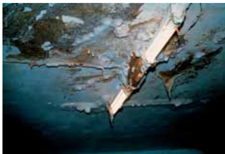
Angreb af Ægte Hussvamp i kælder med høj luftfugtighed. Etageadskillelse mellem kælder og stueetage er angrebet. Der ses mycelium på loftet og et frugtlegerne på lysstofrøret.
