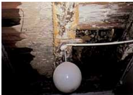
Mycelium og frugtlegerne af Minesvamp i etageadskillelsen under et badeværelse med utæt terazzogulv.
